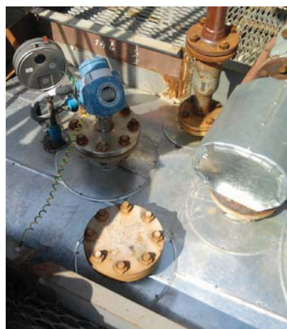
Рис. 1. Rosemount 5300 смонтирован на выпарной аппарате установки серочистки в успокоительной трубе вместо буйкового уровнемера
