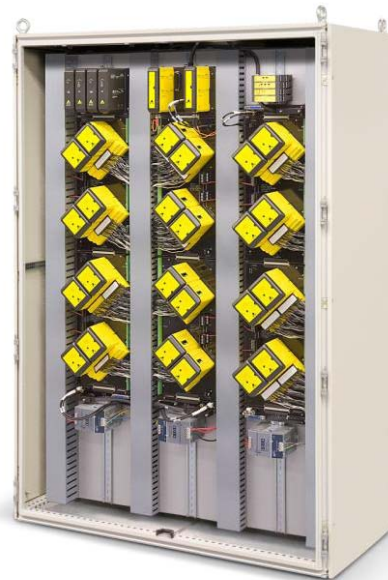
Панели входа / выхода VerticalPlus с аппаратным обеспечением DeltaV SIS, смонтированные в шкафу стандартного размера
