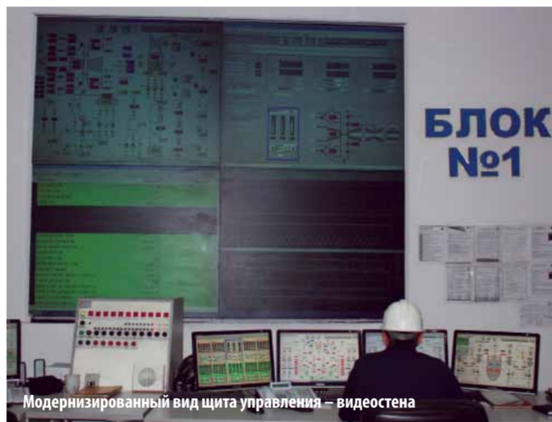
Общий вид станции
