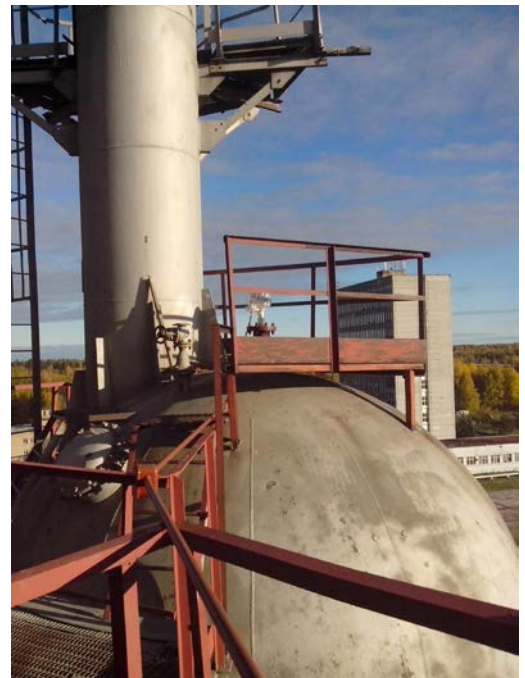
Установка уровнемера 5300 на бункере для измерения катализатора.
