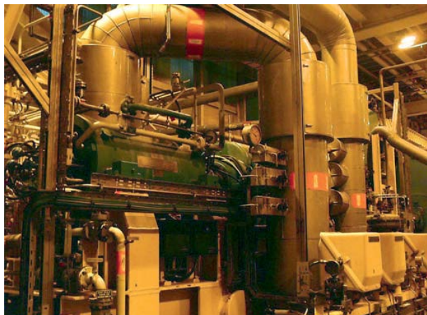
壳牌 Draugen 平台上的气体压缩机 (供图: 艾默生过程管理)
