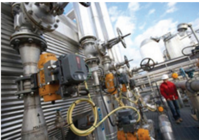
Instalación de FOUNDATION™ Fieldbus en la planta de pulpa más grande del mundo
