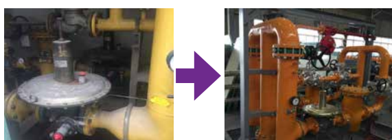
调压撬返厂维修
