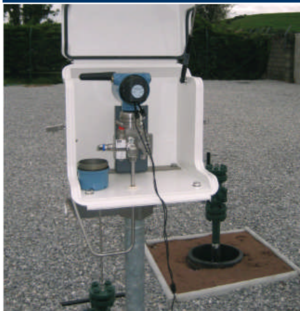
La strumentazione Rosemount montata entro cassette in modo da rispettare gli standard strumentali di Bord Gáis' AGIs.
