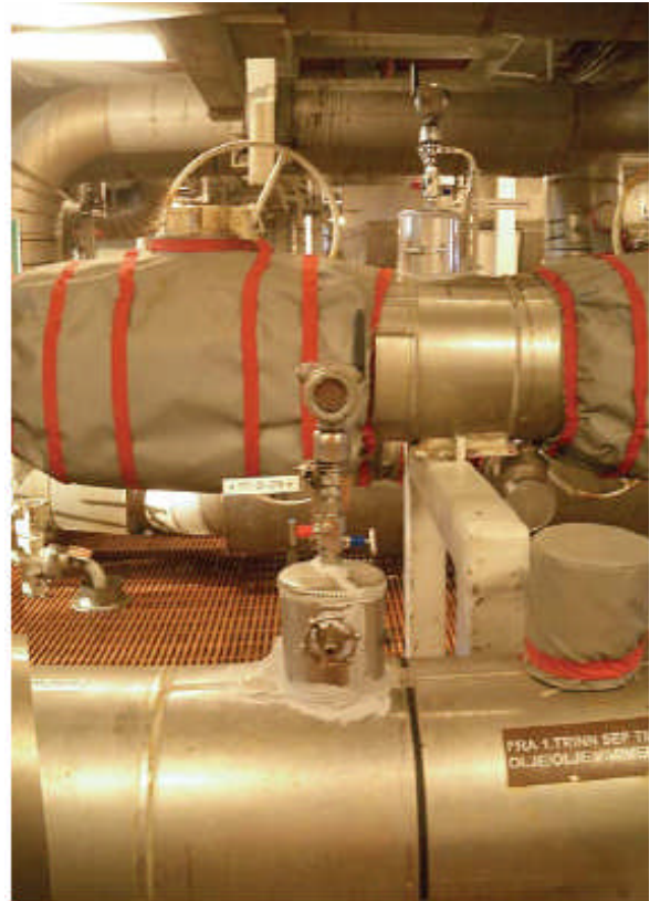
I trasmettitori Rosemount Smart Wireless sono utilizzati per misurare le perdite di carico negli scambiatori di calore della piattaforma.
