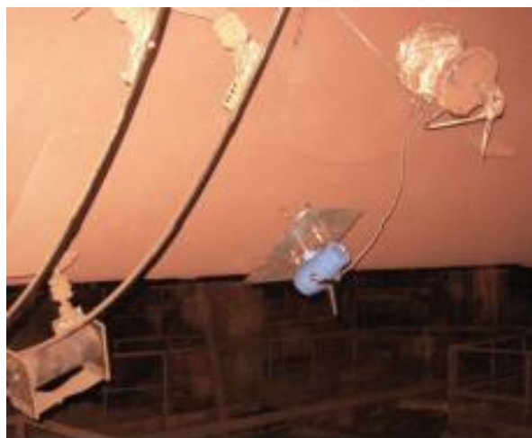
Trasmittitore di temperatura Rosemount 648 Wireless connesso alle termocoppie preesistenti con protezione in ceramica di un forno rotativo
