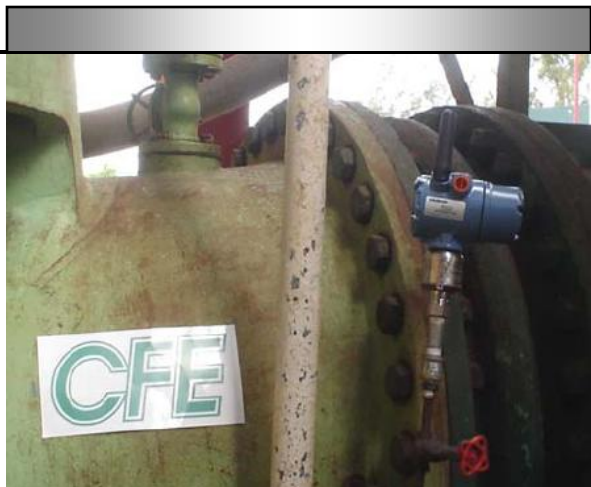
CFE LAPEM utilizza i trasmettitori Smart Wireless in installazioni temporanee
