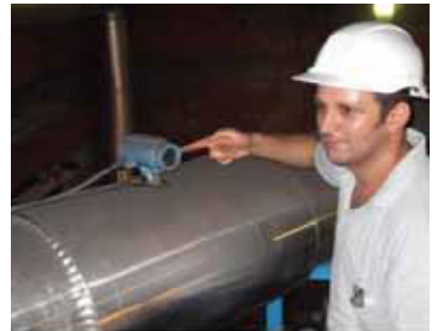
Rosemount Flow 8800D Multivariable Vortex installeret i en mættet damp linie der kommer fra en hjælpekedel
