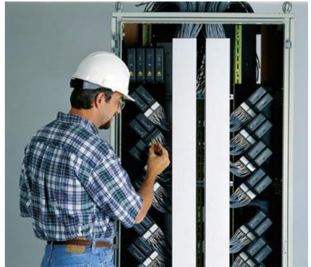
Несущие панели в/в вертикального монтажа, смонтированные в стандартном шкафу.
