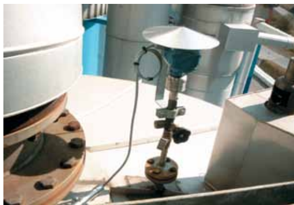
Рис. 3 Сенсор ERS низкого давления, установленный наверху резервуара
