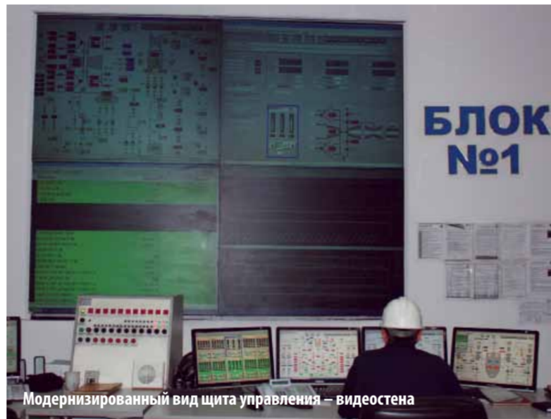
Модернизированный вид щита управления – видеостена
