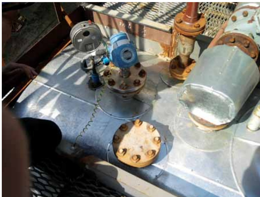
Рис.1. Rosemount 5300 установлен на выпарной аппарат установки сероочистки в успокоительной трубе вместо буйкового уровнемера.
