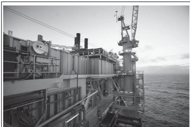
Рис. 3. Установка беспроводных датчиков давления на теплообменниках
