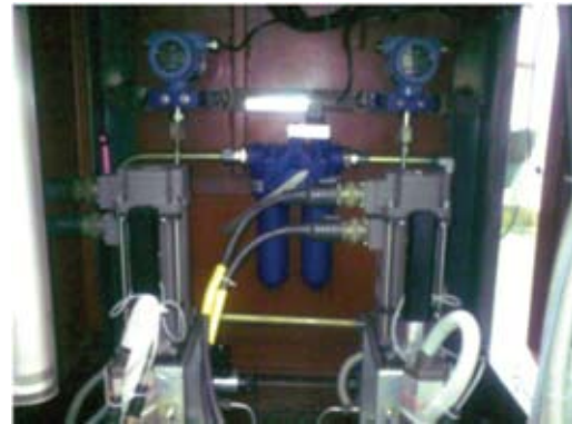
Рис. 2. Модернизация гидромеханической части РЧМ на базе электромеханического сервопривода Exlar
