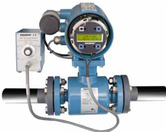
Подключение имитатора 8714 к расходомеру по месту установки без демонтажа из трубопровода.
