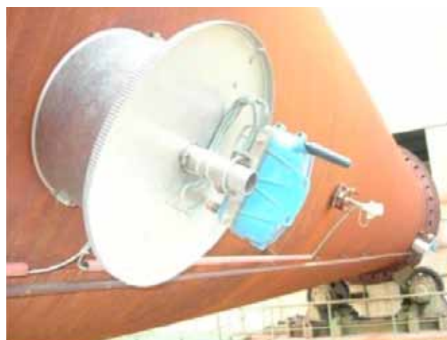
Рис. 2. Многоточечный контроль температуры с беспроводными устройствами с автономным питанием.
