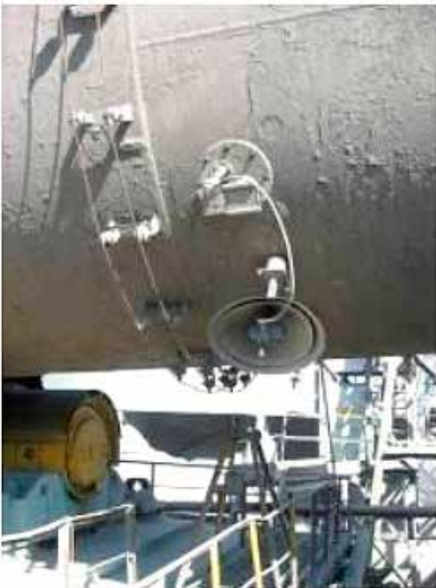
Рис. 3. Выносной монтаж преобразователя, на удалении 40-50 см от поверхности, позволяет снизить температуру электроники до 40-50 градусов.
