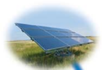
太陽光発電所
