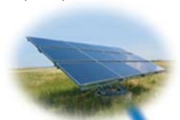
Campo de paneles solares
