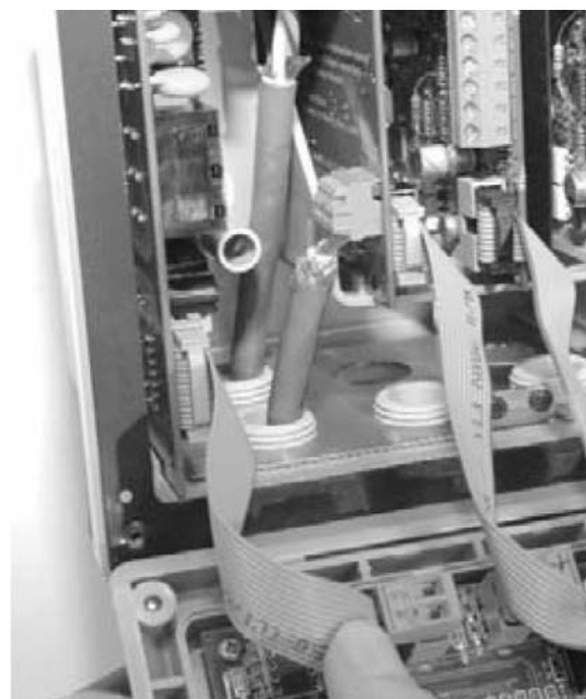
Profibus-Platine mit installiertem Stecker und Kabel
