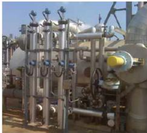
그림 1. 급수가열기의 레벨은 로즈마운트 5300 유도파 레이더(Guided Wave Radar)의 3중 중복장치로 확보된다.
