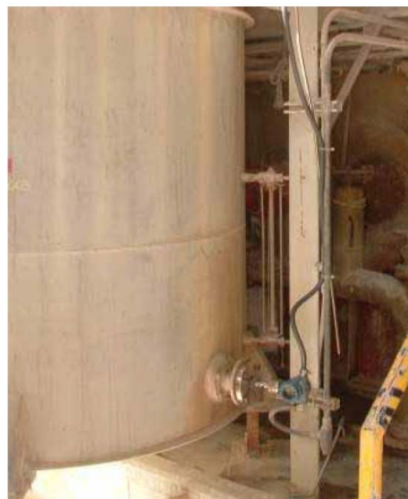
使用 3051S ERS 变送器的真空罐
