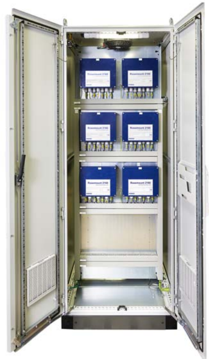
Armoires avec unités d'interface de communication 2160 redondantes
