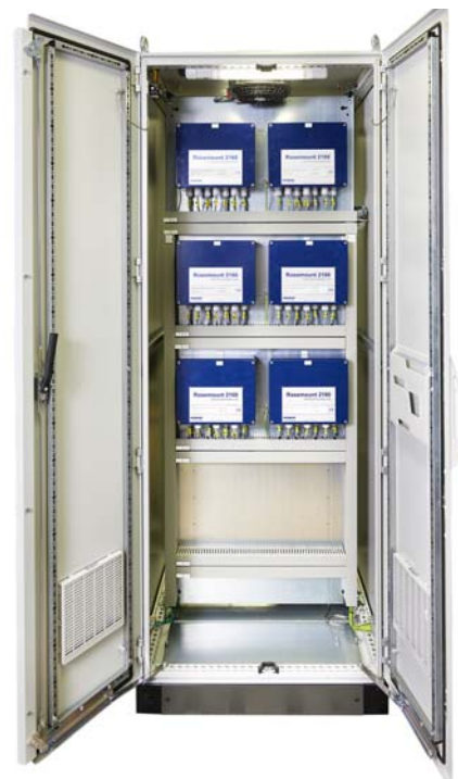
Gabinete com unidades de comunicação de campo redundantes 2160
