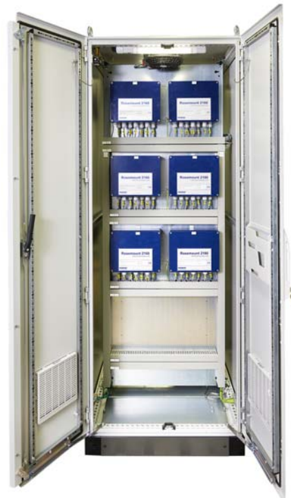
配备冗余 2160 现场通讯单元的控制柜。
