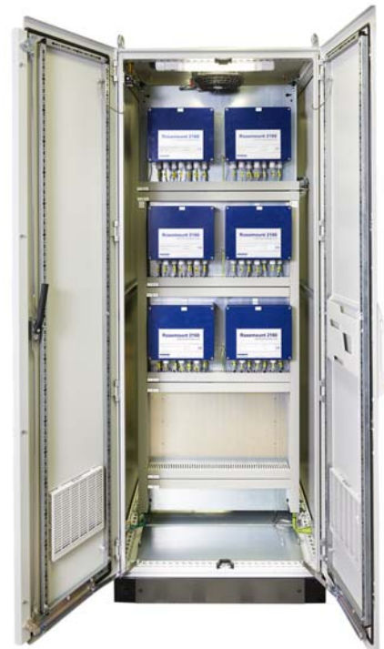
Armario con unidades de comunicación en campo 2160 redundante
