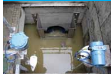
3100 and 3300 on effluent sump
