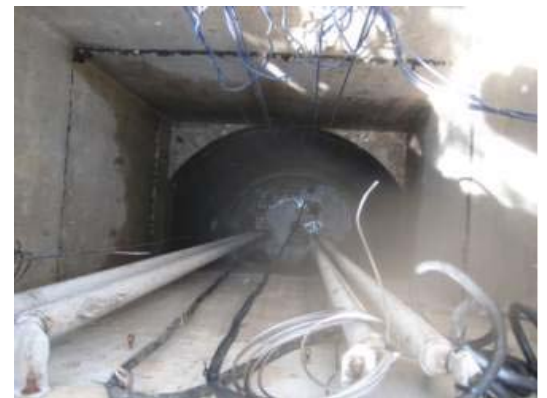
Estación de bombeo 30 Pies de profundidad
