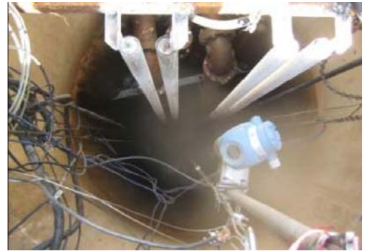
Rosemount 5402 Montaje de gaza en estación de bombeo
