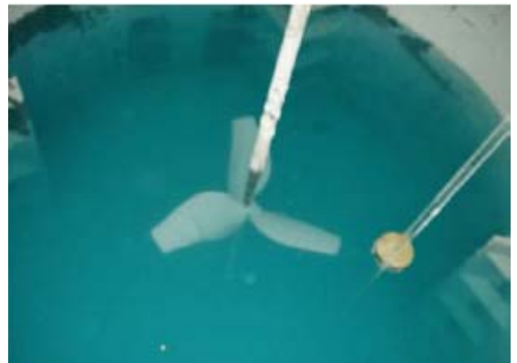
Dentro del tanque el agitador y los deflectores generan turbulencia. A la derecha el antiguo medidor de flotador
