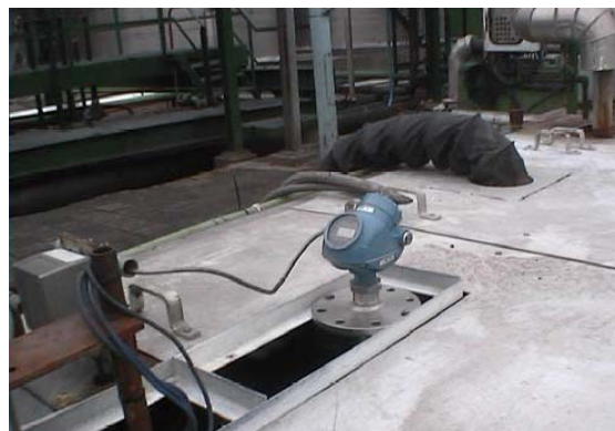
5401 de Rosemount Instalado sobre un tanque recolector de aguas residuales.
