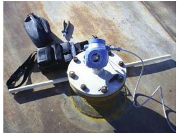
5401 de Rosemount Instalado a 7m de altura en el tanque.
