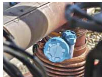
节热器安全泄压阀上检测到的噪声向操作员发出报警，提示存在影响工厂正常运行的潜在问题。
