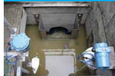
3100 and 3300 on effluent sump
