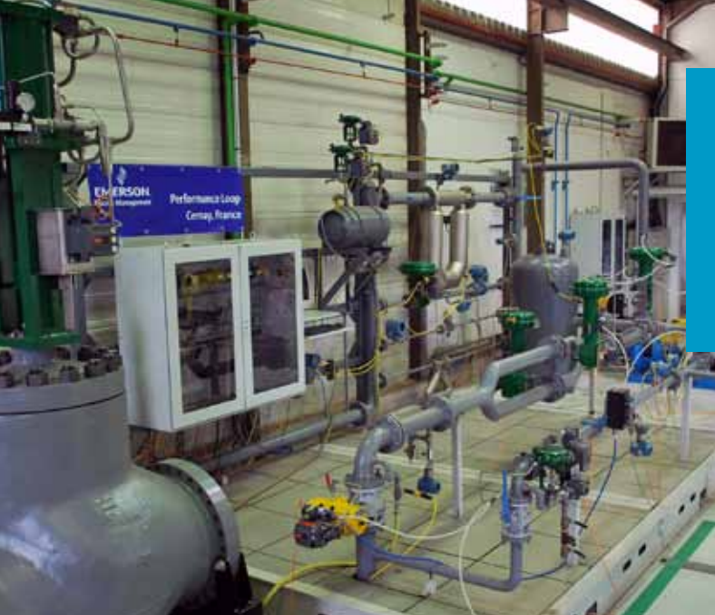
Szabályzó kör, Áramlástechnikai laboratórium, Cernay
