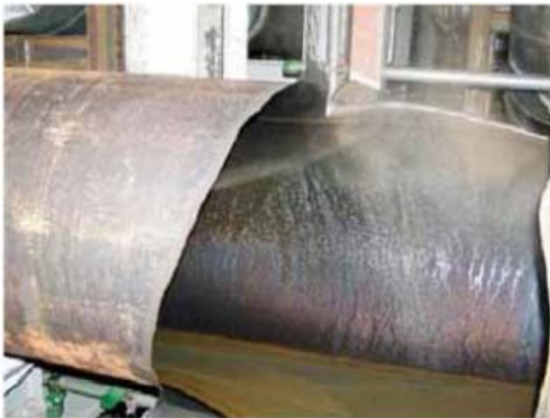
Figur 3. Brott på ångledning orsakade fyra dödsfall
