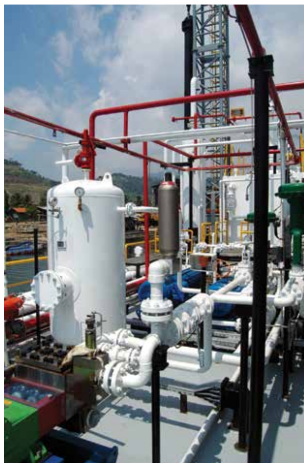
Válvulas de controle Fisher mostradas em um ambiente offshore.
