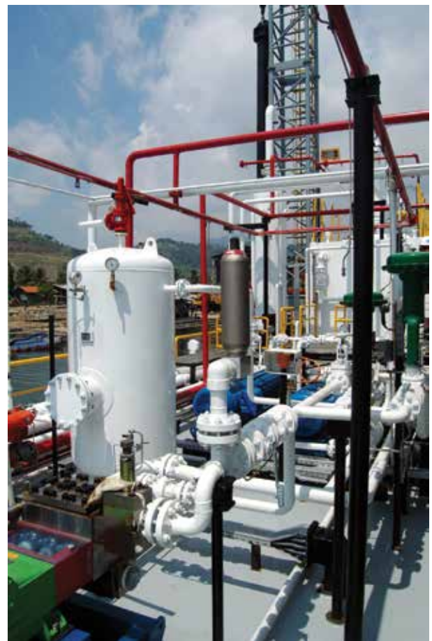
Se muestran válvulas de control Fisher en un entorno offshore.
