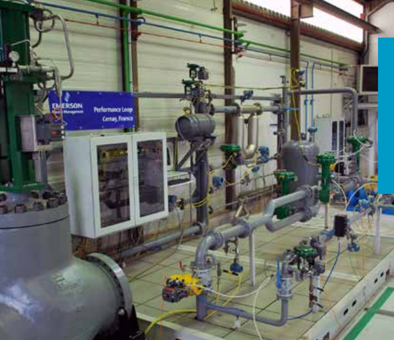
Szabályzó kör, Áramlástechnikai laboratórium, Cernay
