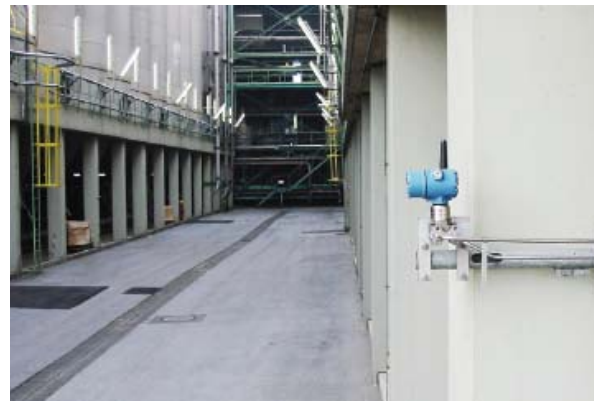
Nell'impianto INEOS di Colonia sono stati installati otto trasmettitori di pressione differenziale wireless Rosemount 3051S
