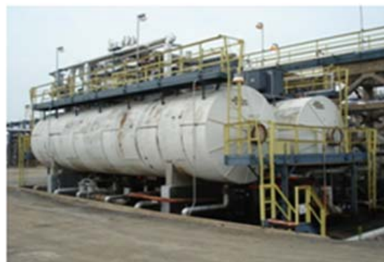
Figura 1. Tanques desalinizadores que requerían una mejora en la fiabilidad de las medidas.
