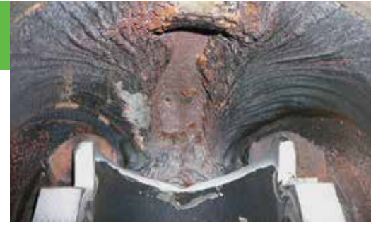
¿Está ocurriendo erosión perjudicial como esta en su válvula?
