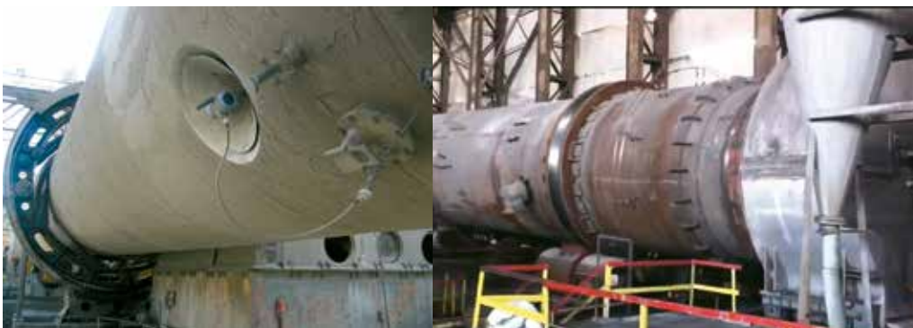
Беспроводной контроль температуры на вращающейся печи
