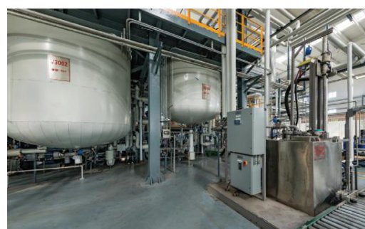
Порционные смесители Emerson, установленные на заводе смазок в Китае.
