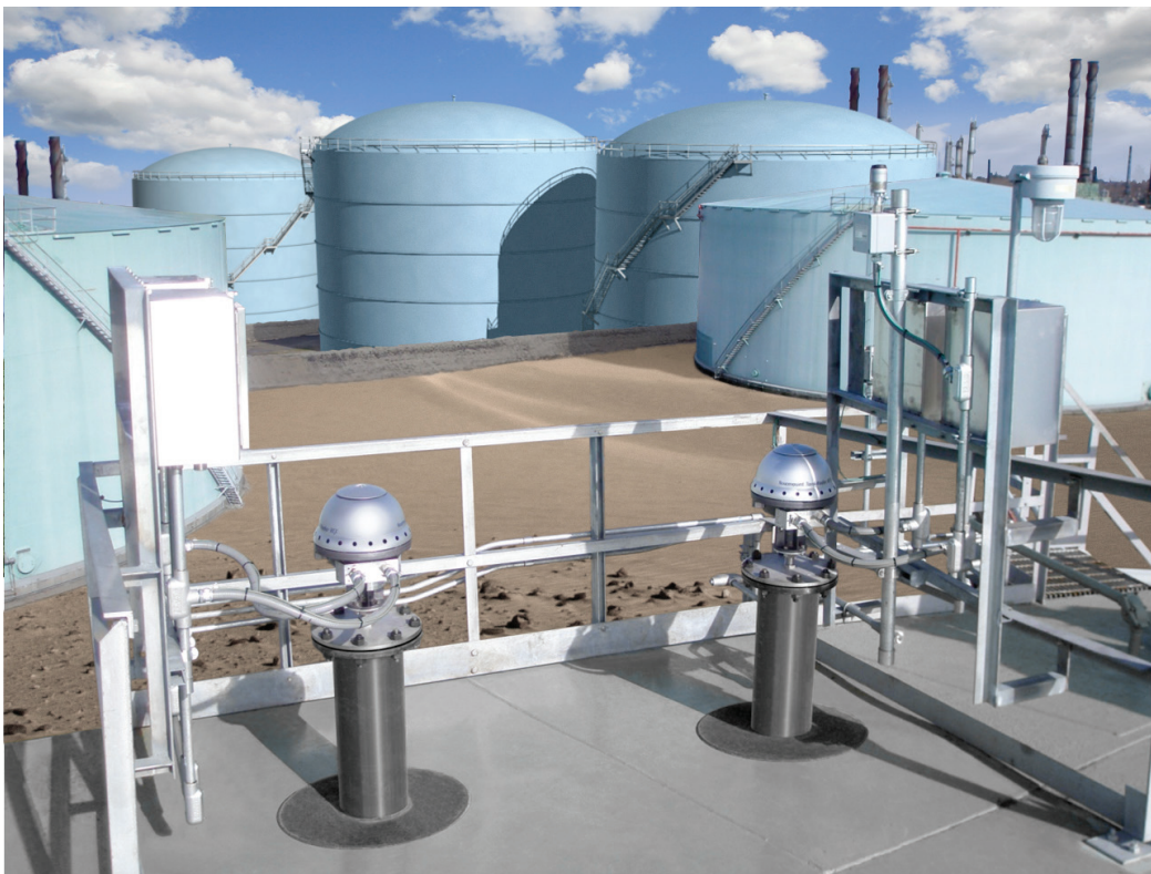
2xATG para medición de nivel y prevención de sobrellenado. Una visión que cada vez es más común cuando se sustituyen los viejos interruptores de nivel mecánico por soluciones modernas
