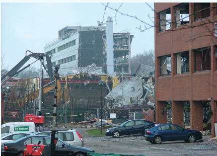
Figura 10.1: Daños a la propiedad después del accidente en Buncefield.
