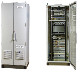
Figura 9.5: Un gabinete del sistema de medición de tanques.
