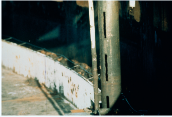
Figura 2.16: La medición por radar del modo de baja pérdida puede utilizarse para eliminar virtualmente la degradación de medición en tubos tranquilizadores antiguos.
