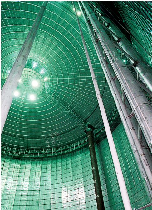
Imagen 7.4: Tanque de contención total utilizado para almacenar gas licuado refrigerado.
