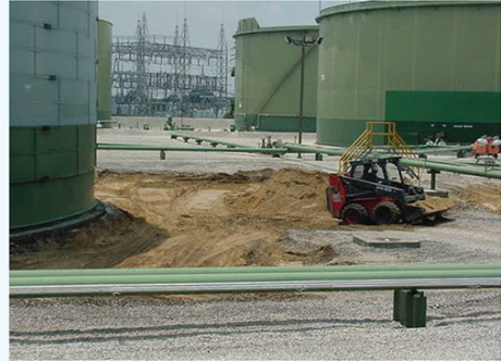
Figura 10.2: Limpieza de derrame en el oeste de Massachusetts.
