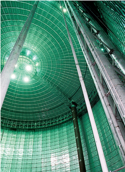
Figura 7.4: Serbatoio a contenimento totale utilizzato per lo stoccaggio di gas liquido refrigerato.
