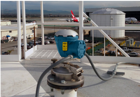
Figura 2.10: Misuratore radar di livello moderno su un serbatoio con tetto fisso.
