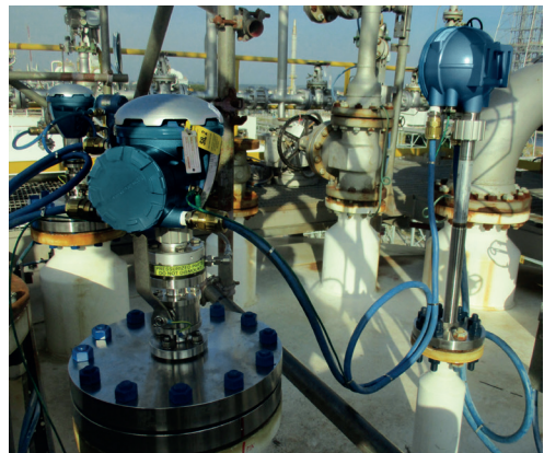
Figura 9.3: La ridondanza del serbatoio è ottenuta con due misuratori del serbatoio e strati di comunicazione separati - cablati e wireless.
