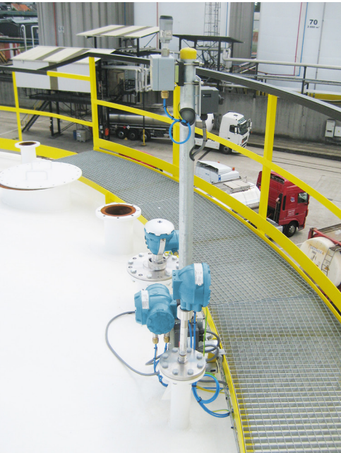
Figura 9.8: Antenna connessa ai dispositivi del serbatoio.
