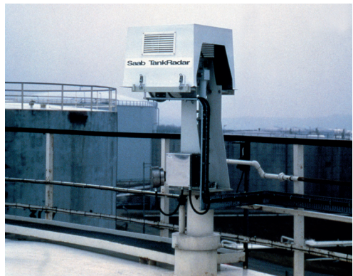
Figura 2.9: Il primo misuratore radar a elevata accuratezza installato nel 1985 su un serbatoio di raffineria.
